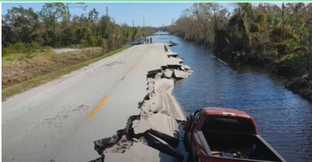
Figura 19: Daños significativos en las carreteras del condado de DeSoto a lo largo del río Peace 91
