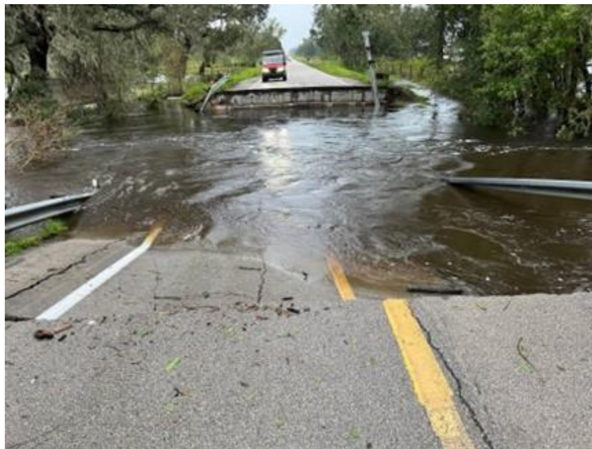
Figura 35. Una parte del puente de la carretera 64 cerca de Pioneer Park en el condado de Hardee se derrumbó debido al huracán Ian
