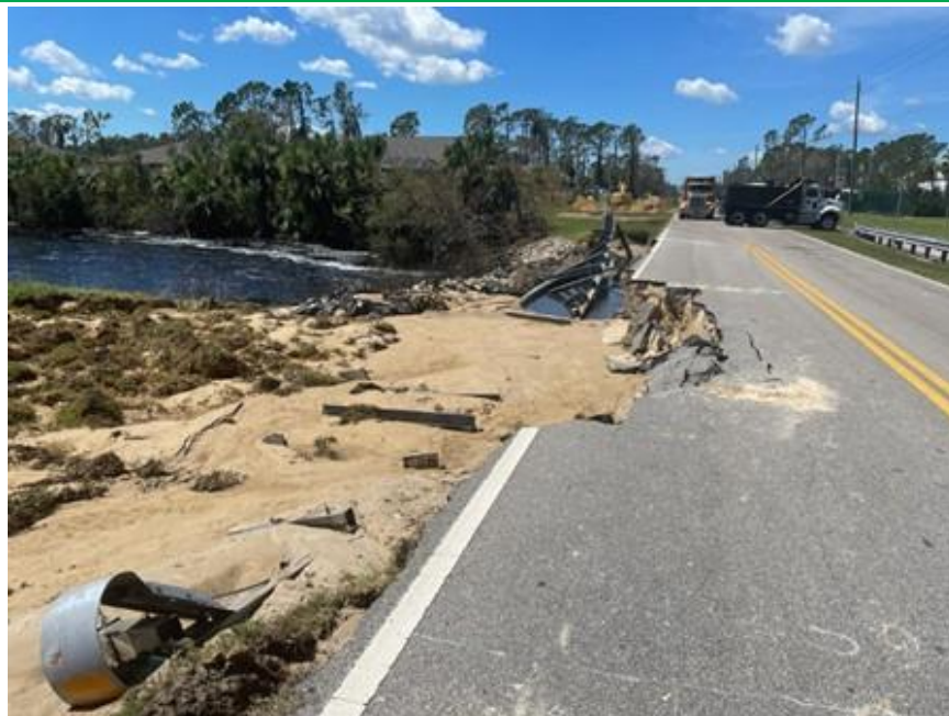
Figura 17: Daños en las carreteras y deslave parcial cerca del río Myakka en North Port, Florida 89
